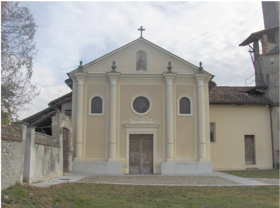
Chiesa e oratorio : portoni d'ingresso da restaurare
