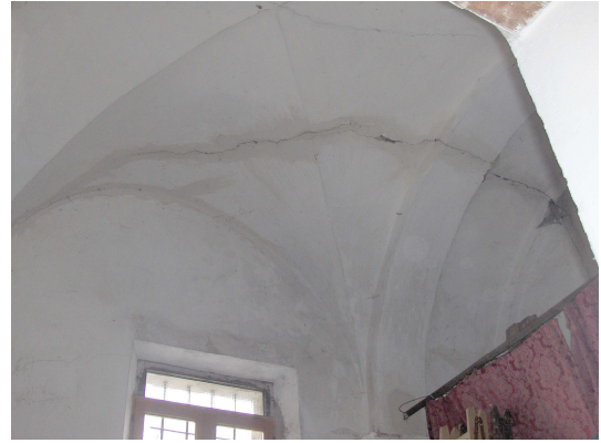
Volta fessurata locale adiacente Battistero
